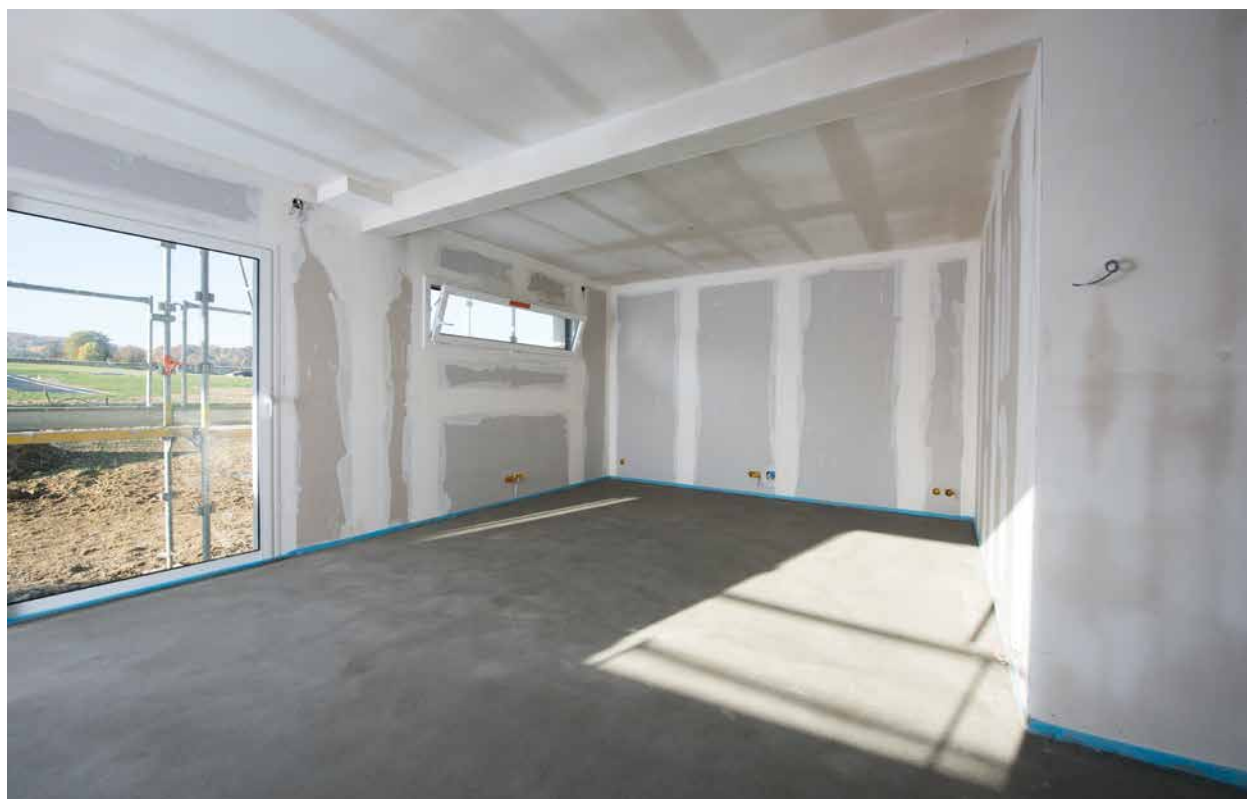
Maison Optima - Hagental le bas (68) - Mise en œuvre de la chape hydraulique
